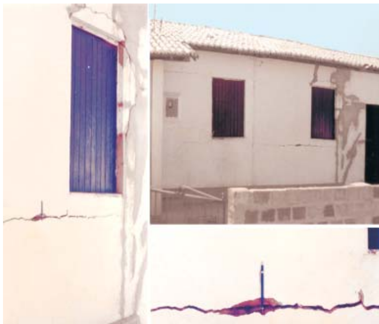
Figura 9.14 – Danos provocados em casas no município de Petrolândia (PE) (AMORIM, 2004).
