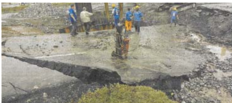
O BURACO provocado pelo rompimento de tubulações do emissário da Barra, administrado pela Cedae, na Avenida Ayrton Senna, por onde passam por dia cerca de mil veículos
