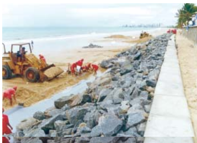
Figura 9.16 – Muro para contenção da erosão marinha construído na praia de Boa Viagem (PE), em 1995, no mesmo local apresentado na figura anterior.
