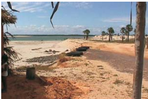
Figura 13.14 – Erosão do litoral do Maranhão – delta do rio Parnaíba. Porção de costa apresentando processo erosivo violento (700 a 800 m em dois anos), destruindo uma rodovia. Coordenadas: W 41° 27'06"; S 2° 54'23,3". Fotografia: V. J. Marques.
