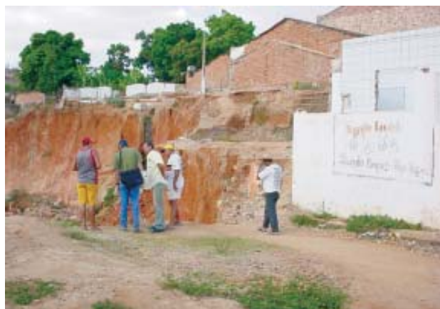
Figura 9.12 – Deslizamento translacional (notar os três patamares formados pelo deslizamento), que evoluiu para uma grande voçoroca (Quipapá, PE).
